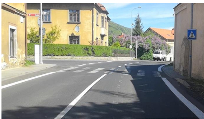
Obrázek 17 -Přechod pro chodce, který má opotřebený VDZ V7a a navazující chodníkové plochy bez prvků pro OOSPO v ulici Rooseveltova (zdroj: Tereza Dalecká)
