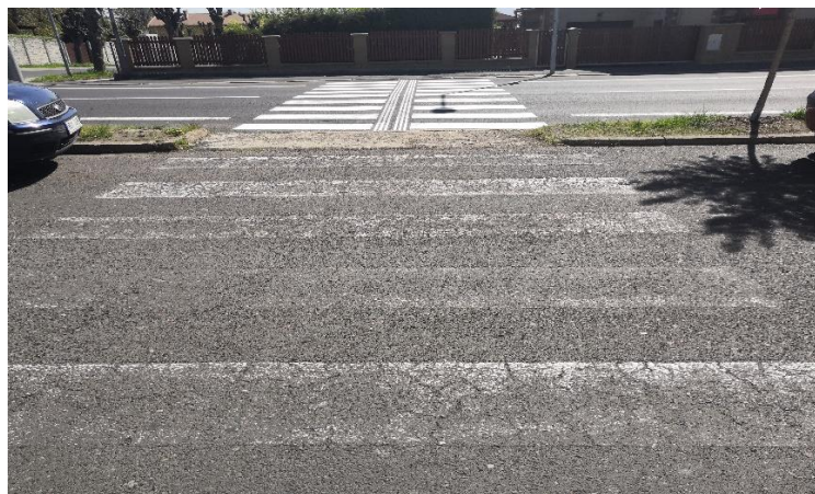
Obrázek 18 - Opatřebené dopravní vodorovné značení a nevhodné řešení dopravního ostrůvku bez prvků pro OOSPO v ulici Tyršova (zdroj: Tereza Dalecká)
