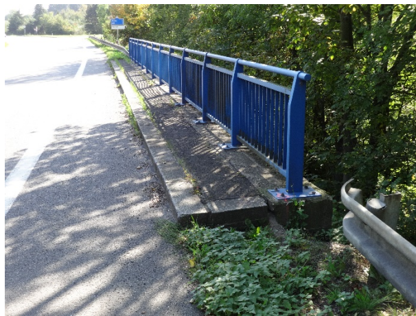
Obrázek 7 – Bližší pohled na bezpečnostní deficit na severním rameni křižovatky, v podobě nesprávného napojení svodidel na zábradlí mostního objektu.
