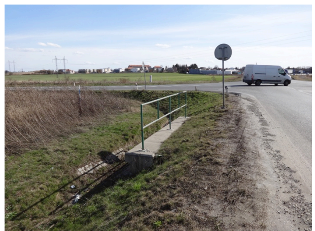
Obrázek 7 – Bližší pohled na bezpečnostní deficit (zábradlí s betonovým základem) nacházející se mezi severním a východním ramenem křižovatky.
