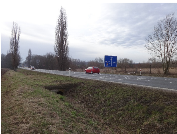
Obrázek 12 – Bližší pohled na bezpeč. závadu (betonové sloupky a propustek) nacházející se podél východního ramene křižovatky B.
