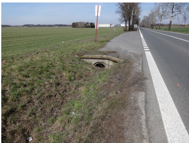
Obrázek 6 – Bližší pohled na bezpečnostní deficit (betonový propustek) nacházející se na severním rameni křižovatky (silnice I/38).
