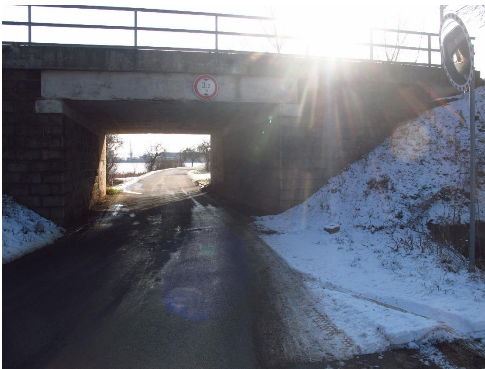
Obrázek 52. Oslnění řidičů jedoucích směrem na jih po silnici S III/10163 těsně před úzkým silničním podjezdem pod železniční tratí č. 010
