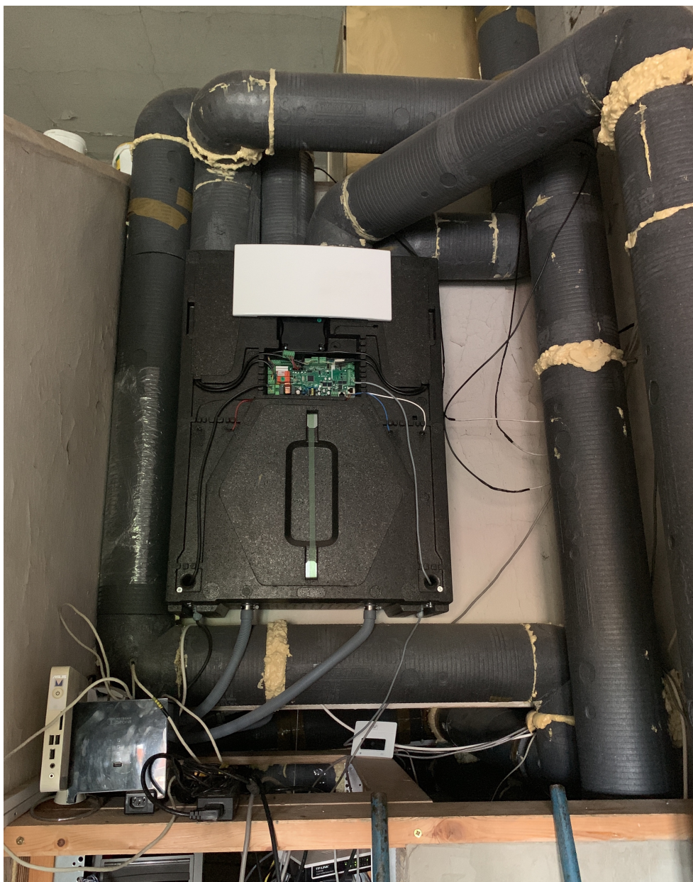
Obrázek C.4: Rekuperační jednotka – S připojenými čidly chytrého domu.
