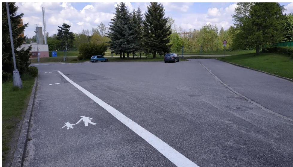
Obrázek 13: Asfaltová plocha v areálu školy bez fyzického oddělení pěšího provozu
