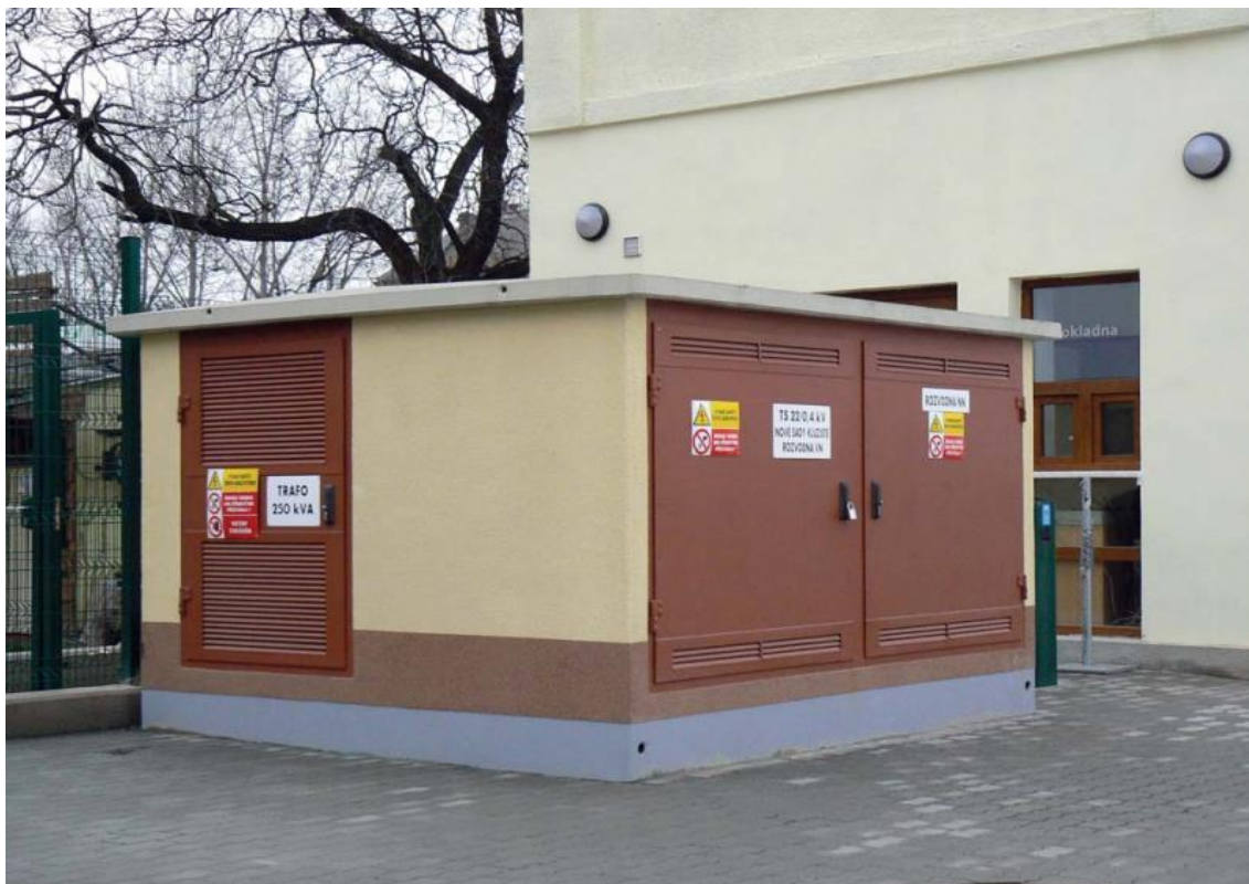
Obrázek 8: Blokovaná stanice VN/NN [20]
