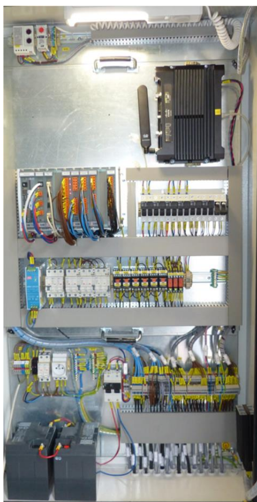
Obrázek 11: Sekundární technika chytré distribuční trafostanice
