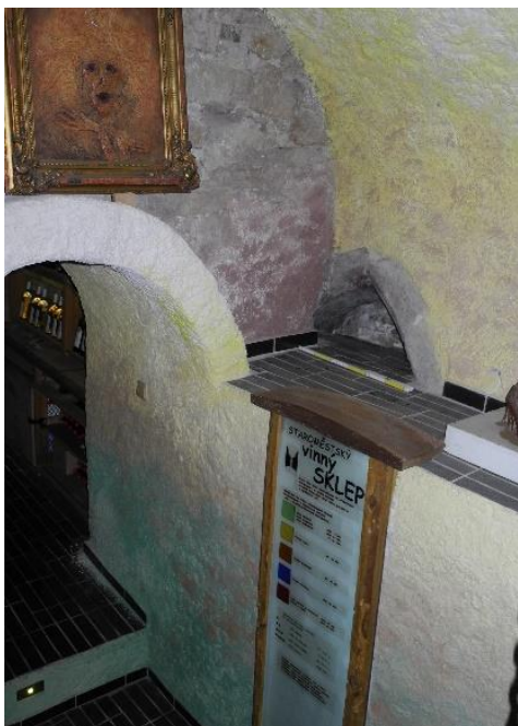
Dům čp. 104, přední sklep, pohled na ostění s lomeným obloukem v dělicí stěně s domem čp. 105.
