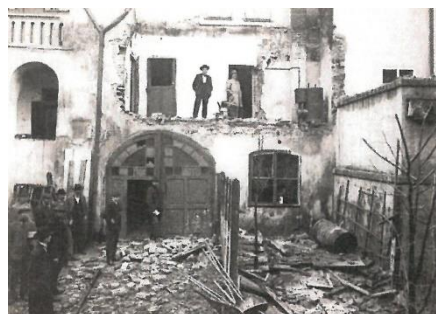
Pohled na dvorní průčelí domu čp. 93 po jeho poškození výbuchem v roce 1902 (Obrázky z Mladé Boleslavi)
