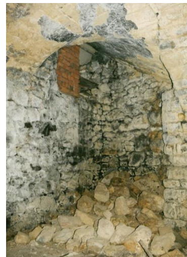
Pohled k otvoru v pravém rohu sklepa, který je pravděpodobně pozůstatkem původního vstupu
