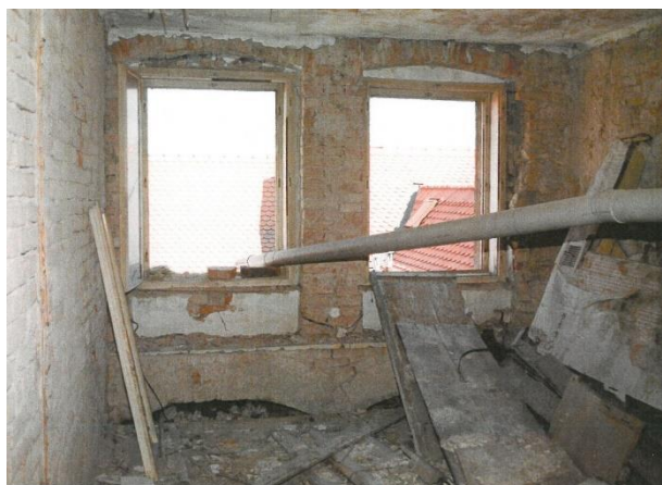
Dům čp. 17, zadní místnost patra, pohled na pasy původní okenní arkády, zakryté druhotně sníženým stropem
