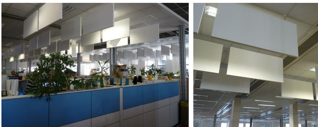
Obr. 92: Akustické panely zavěšené pod stropem v blízkosti chladících trámů
