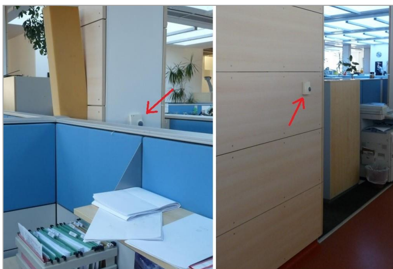
Obr. 91: Čidlo pro regulaci sekce CHIT je částečně zakryto nábytkem (vlevo) a jiné je umístěno v komunikačním koridoru (vpravo)
