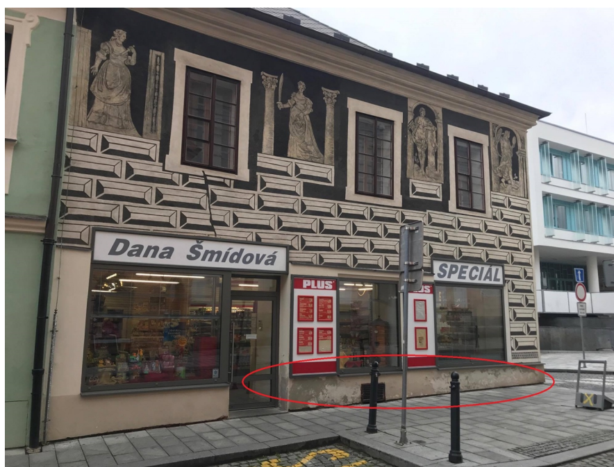
Obrázek 26: Degradace omítky v soklové části
