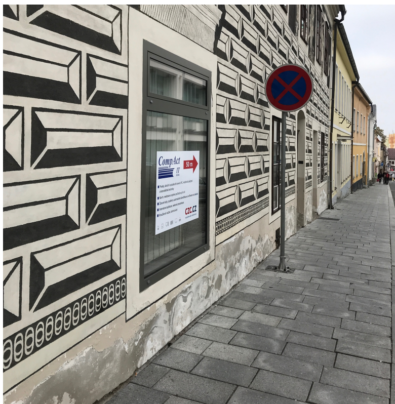
Obrázek 27: Pohled na východní fasádu – odpadávání omítky v okolí soklu
