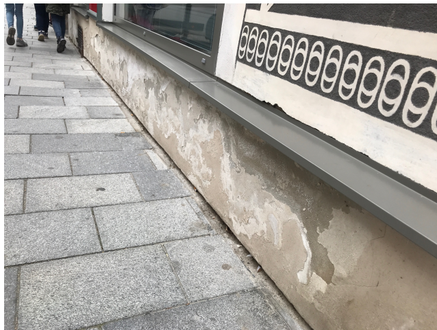
Obrázek 29: Poruchy na soklu na severní části fasády
