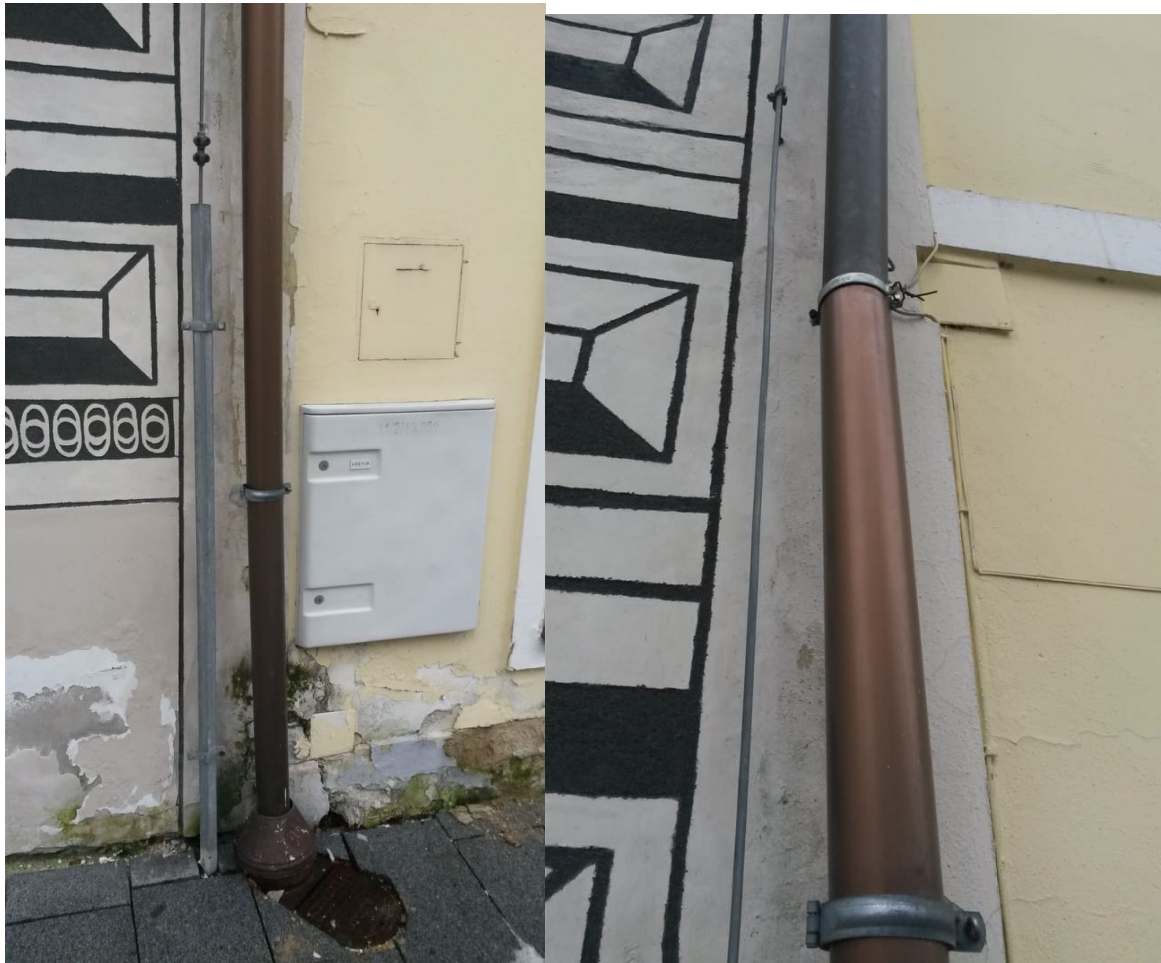
Obrázek 30: Zakončení svodu na východní fasádě – ve spodní části bez poruch – ke zvýšené vlhkosti dochází v důsledku poruchy ve střední části – napojení plastového svodu na měděný – stékáním vody po fasádě dochází ke zvýšené vlhkosti v dolní oblasti a degradačním procesům (dolní část plastová z důvodu vandalismu, několikrát byl měděný svod poškozen/odcizen)
