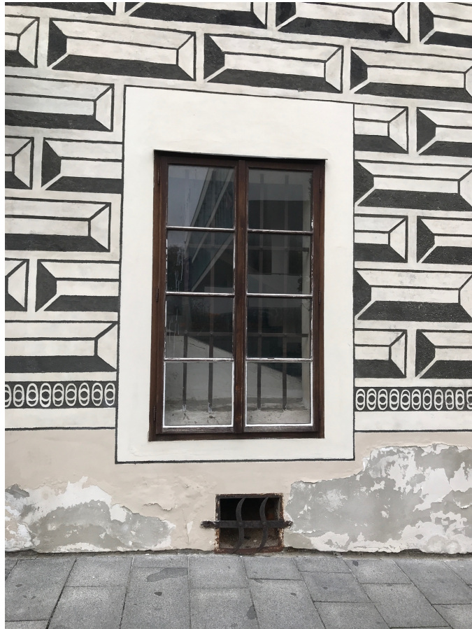
Obrázek 28: Pohled na větrací mřížku do sklepa – v okolí mřížky zjevná eliminace poruch - v důsledku cirkulace vzduchu mřížkou dochází k vysychání
