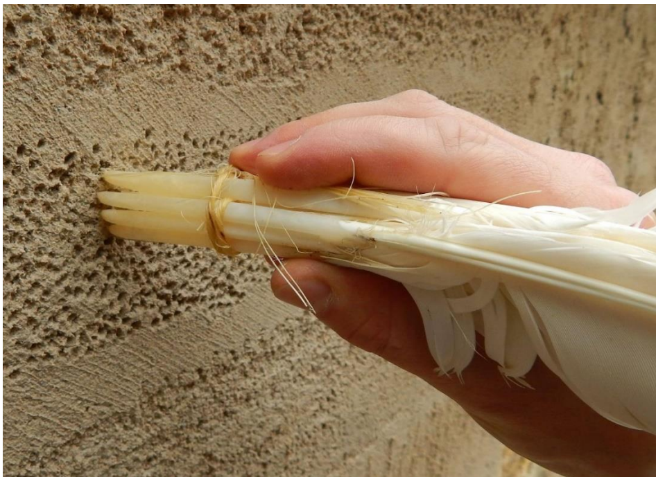
Obr. 15 Vypichovaná omítka [zdroj 12]
