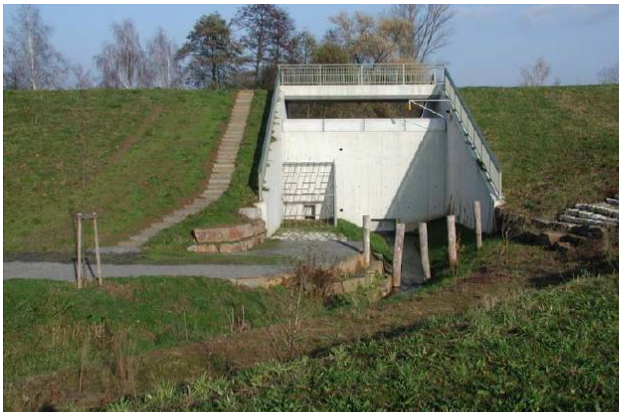
Obr. 3 Retenční suchá nádrž – protipovodňová ochrana města Hambach, Aubach [4]
