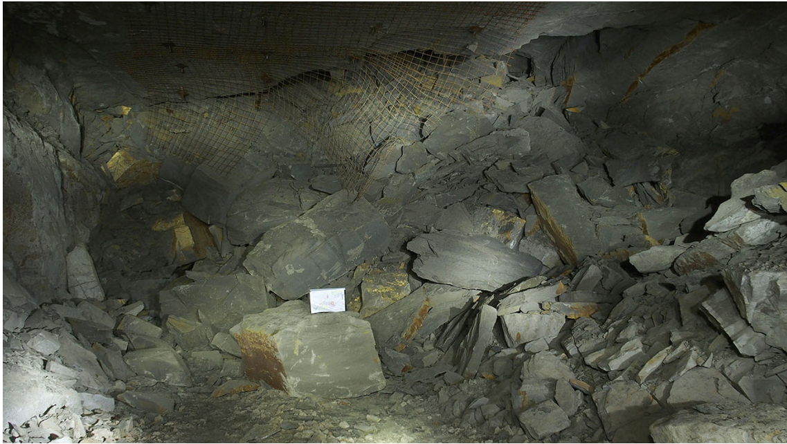
Obrázek 5.1: Pohled na zával v chodbě č. 1 s pomyslným měřítkem (papír A4). Foto Archiv SÚRAO
