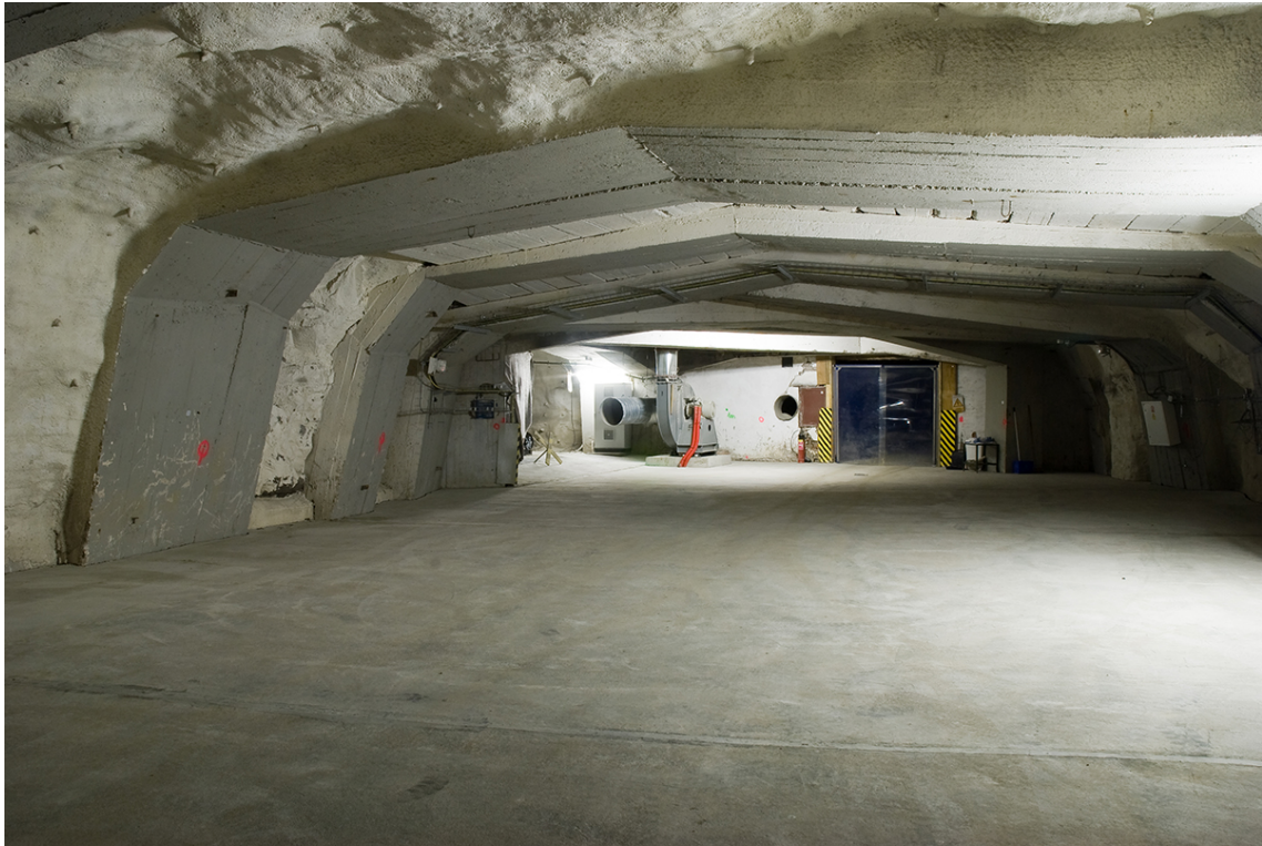
Obrázek 4.2: Obslužná chodba se vzduchotechnikou [26]
