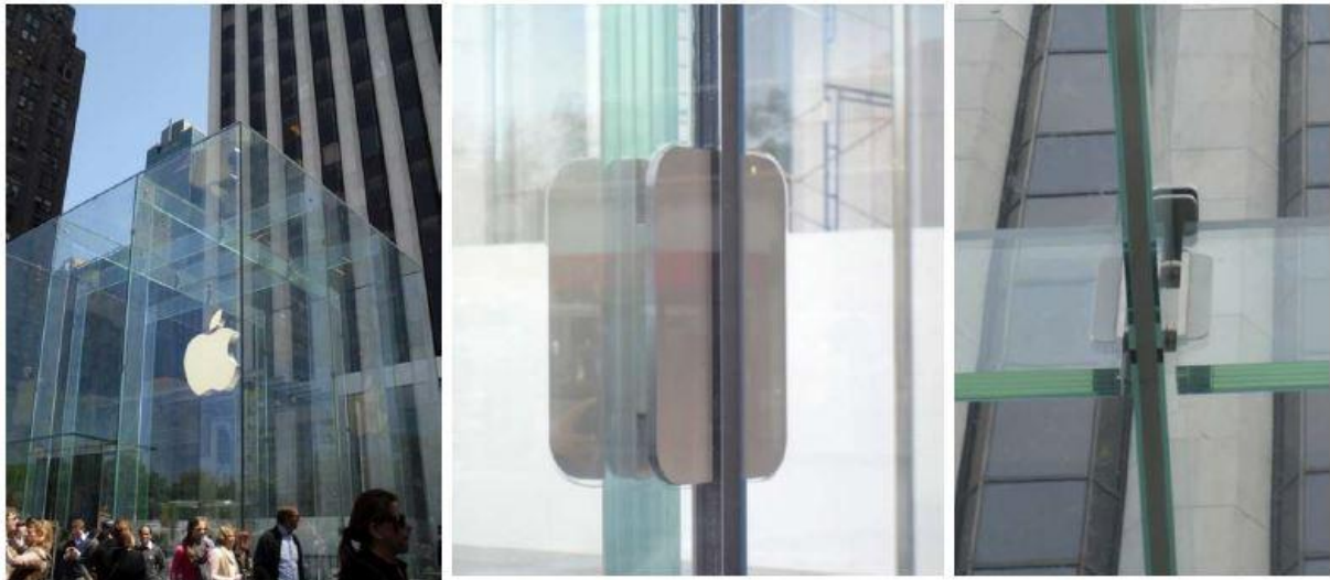
Obr. 21 Vložené laminované spoje Apple Retail Store, New York, USA [3]
