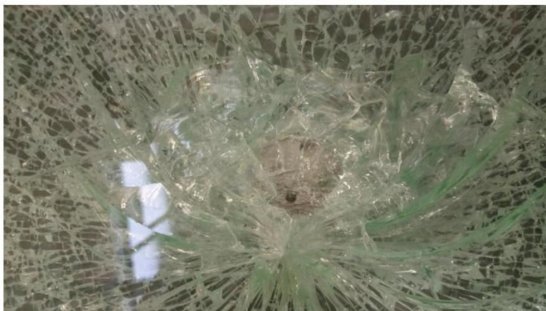
Obr. 53 Detail plaveného skla vzorku S1-01 po porušení
