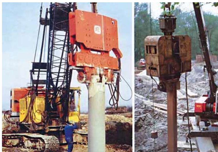
Obrázek 6: Starší elektrický vibrátor z počátku sedmdesátých let minulého století (vpravo) a novější hydraulický vibrátor z počátku osmdesátých let (vlevo), výrobky francouzské firmy PTC. [2]
