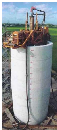
Obrázek 35: Spouštění otevřeného železobetonového kesonu o průměru 3,5 m a hloubce 80 pro podzemní multireaktor ČOV [8]
