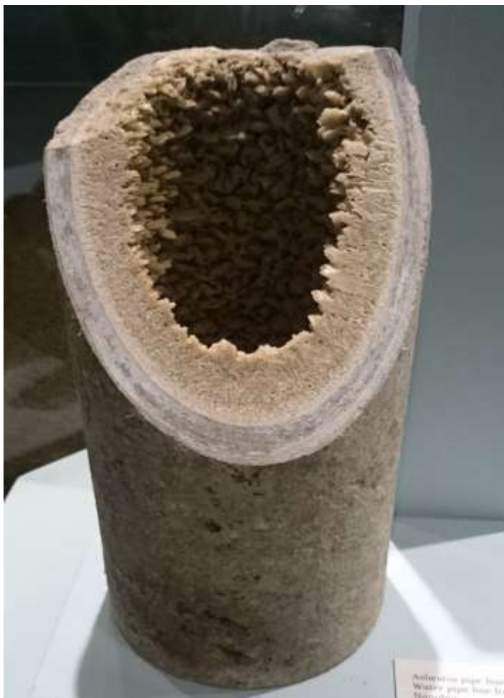
Obr. 23: Zúžené azbestocementové potrubí tlakového vodovodu – Namibie [77]
