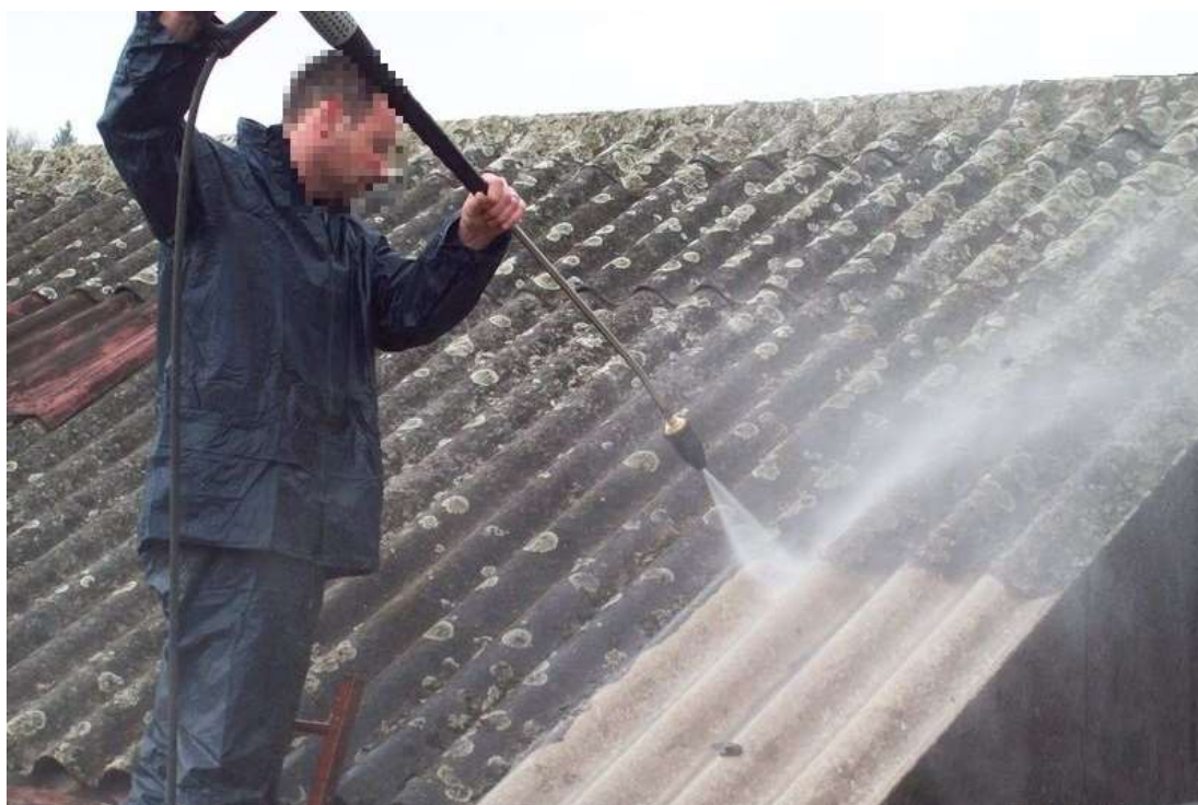
Obr. 24: Problémové mytí azbestocementové krytiny tlakovou vodou [114 - upraveno]
