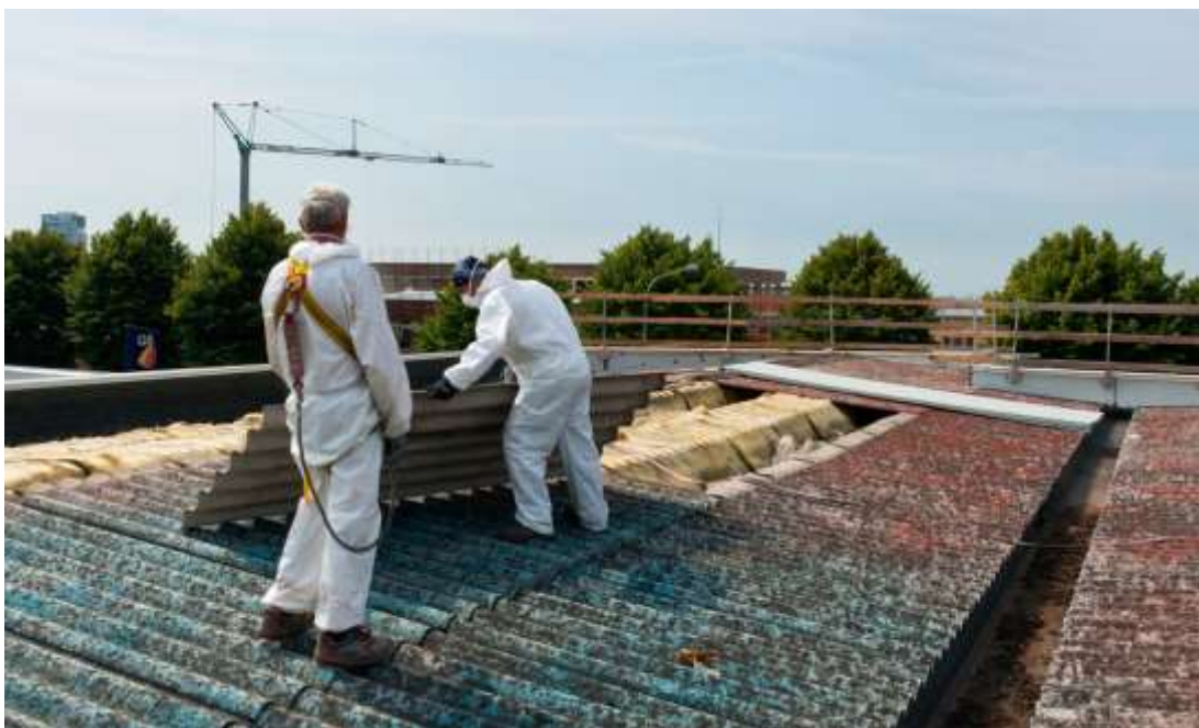
Obr. 27: Azbestocementová krytina ošetřená enkapsulačním nástřikem [86]
