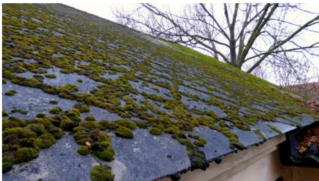
Obr. 20: Kontaminace AC střešní krytiny výtrusnými rostlinami - Líčkov, objekt č. 12 [archiv autora]
