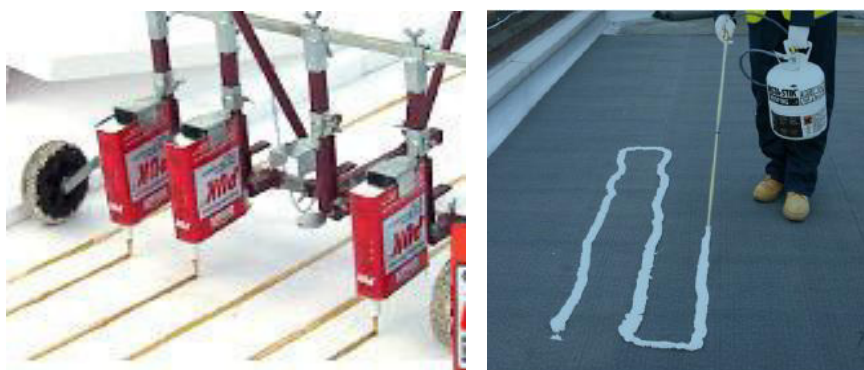
Obr. 13: Lepení tepelné izolace tekutým a nízko-expanzním lepidlem (Převzato z [Technický list výrobku])
