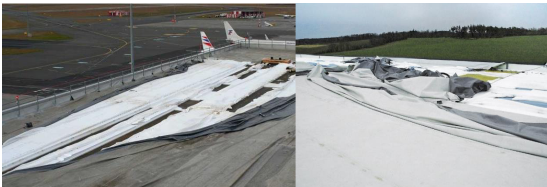
Obr. 10: Poruchy plochých střech vlivem špatné stabilizace (Převzato z [17])
