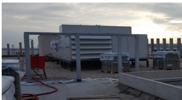
Obr. 18: Ocelové prvky a vzduchotechnická jednotka na střeše (vlastní zdroj)
