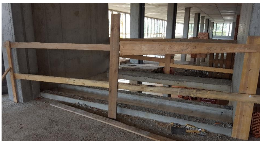
Obr. 19: Zajištění proti pádu z výšky zábradlím (vlastní zdroj)
