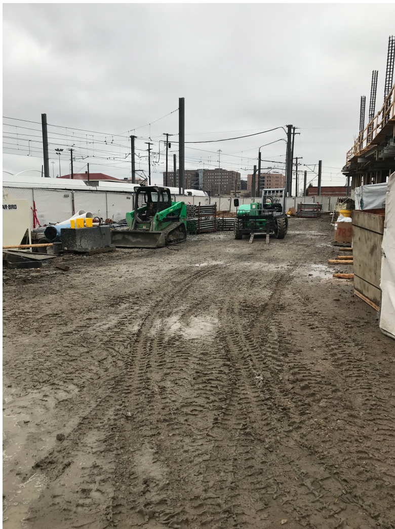
Obr. 7: Staveništní komunikace bez úpravy. Zdroj: Autor práce
