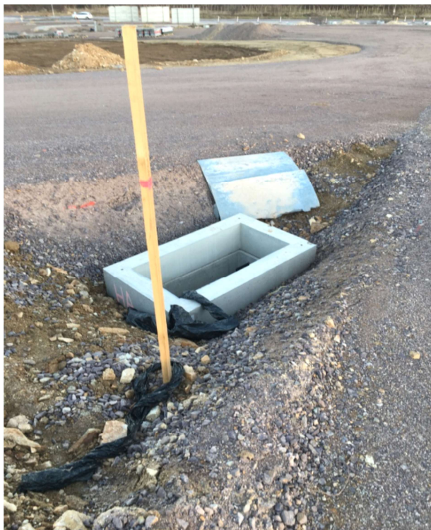
Obrázek 4 – Chybějící zajištění otvoru
