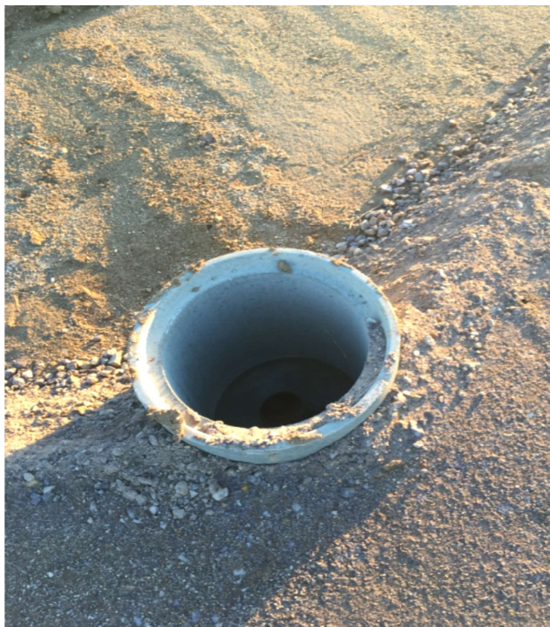
Obrázek 3 – Chybějící zajištění otvoru – poklop
