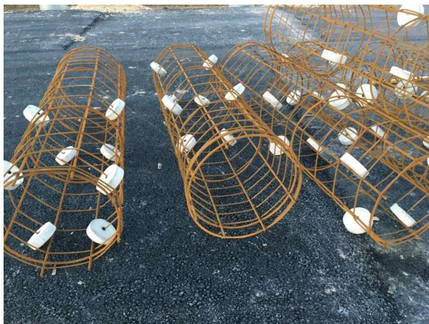
Obrázek 8 – Nesprávné skladování materiálu – chybějící podložky
