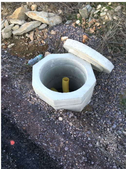
Obrázek 7 – Chybějící zajištění otvoru – poklop
