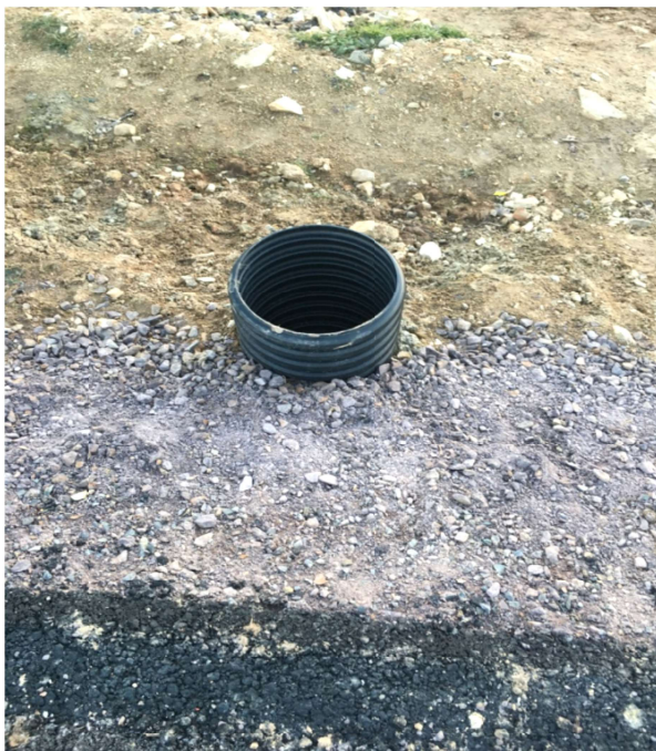
Obrázek 9 – Chybějící zajištění otvoru – poklop
