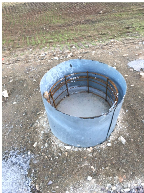
Obrázek 6 – Chybějící zajištění ostré hrany/ výztuže
