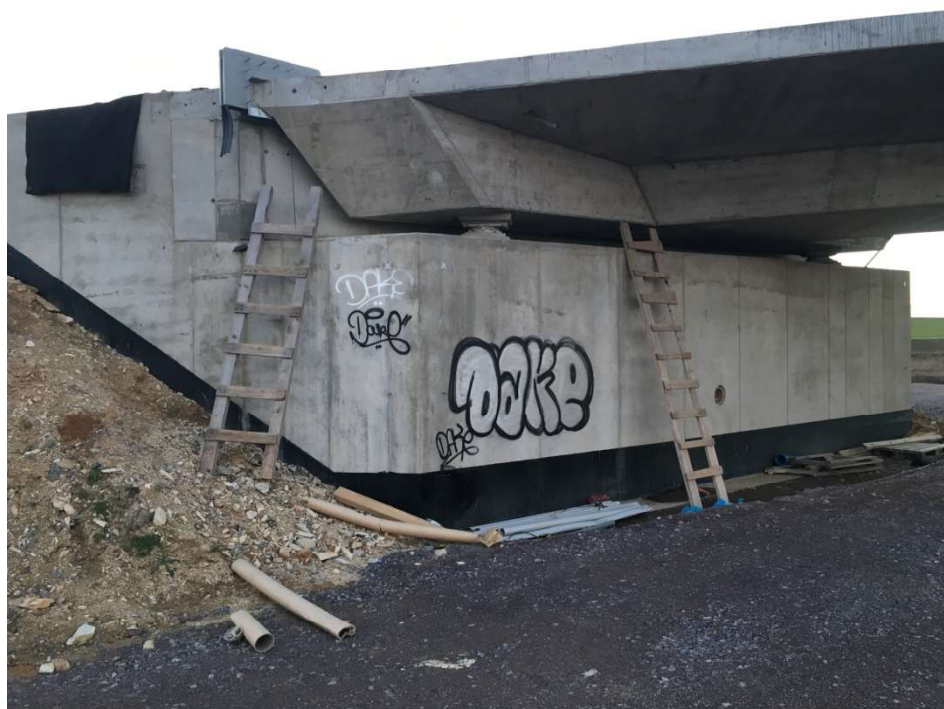
Obrázek 11 – Nezajištěný žebřík a nesplňující požadavky
