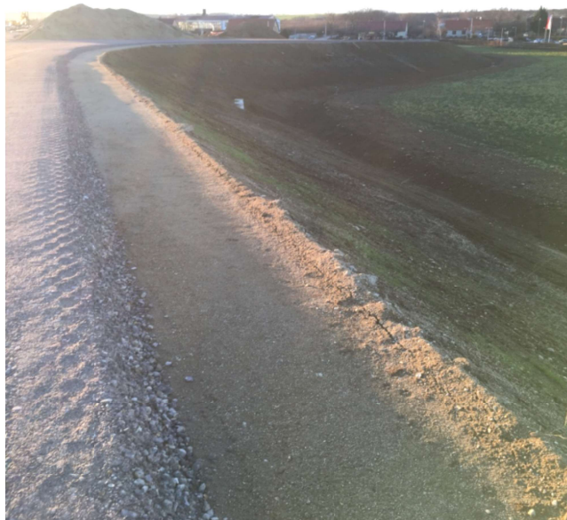
Obrázek 2 – Nezajištěná hrany svahu
