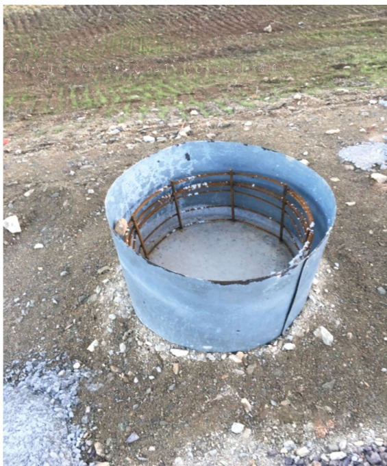
Obr. 57: Chybějící zajištění ostré hrany
