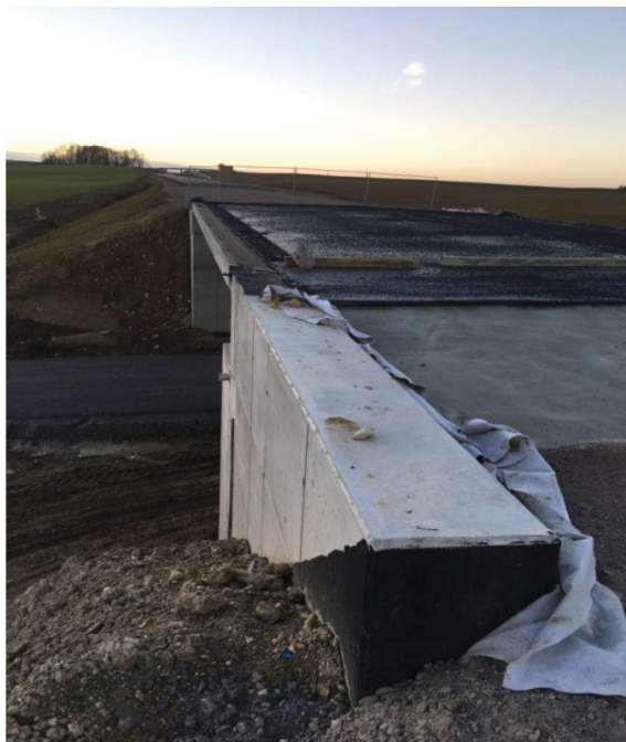
Obr. 65: Nezajištěná hrana pádu – most
