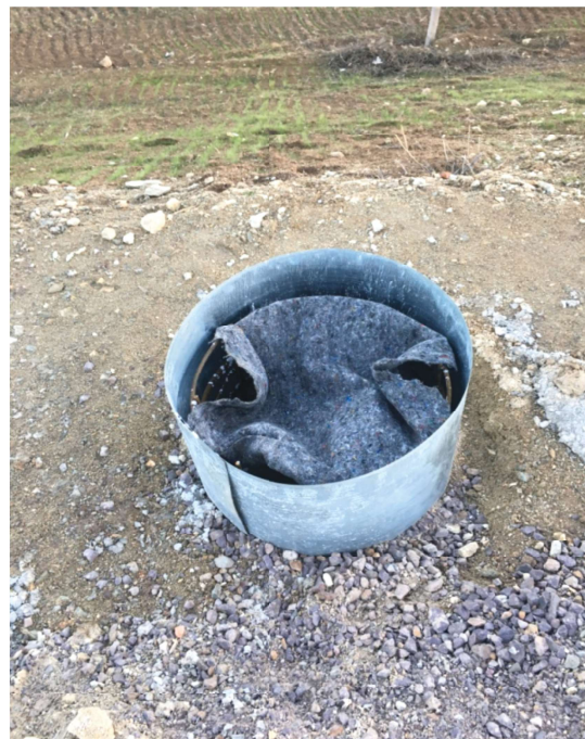
Obr. 58: Chybějící zajištění ostré hrany
