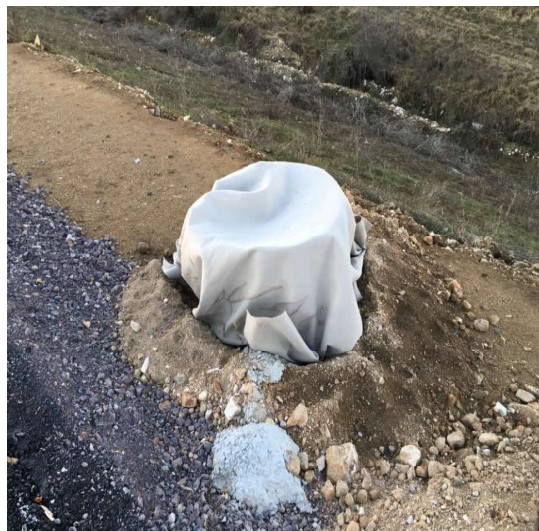
Obr. 60: Ukázka zajištění ostré hrany
