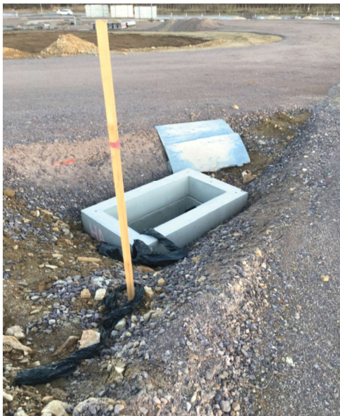
Obr. 55: Chybějící zajištění otvoru
