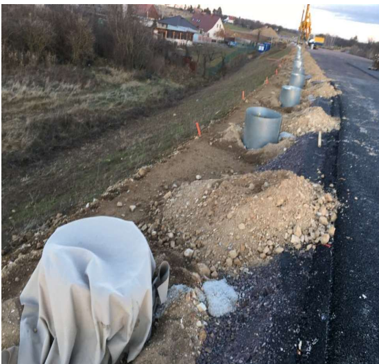
Obr. 59: Ukázka zajištění ostré hrany
