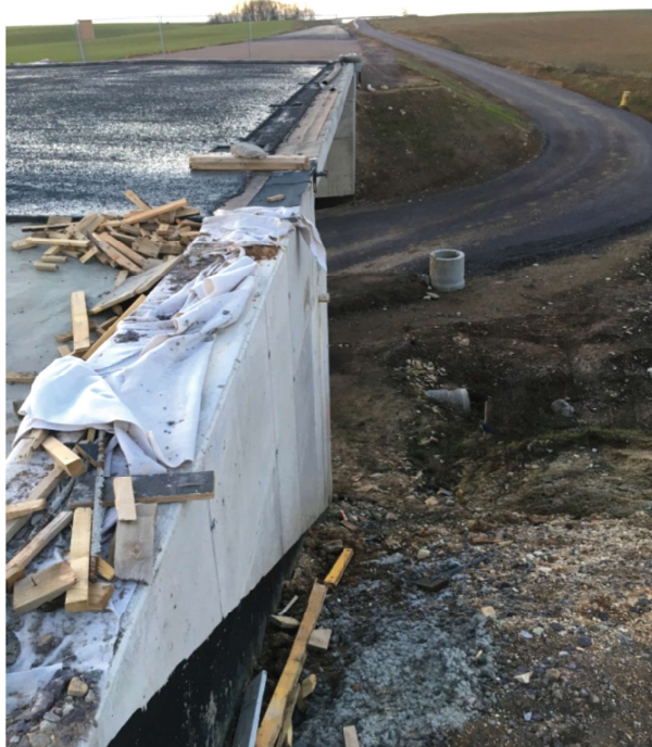
Obr. 66: Nezajištěná hrana pádu – most
