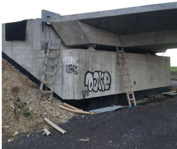
Obr. 56: Nezajištěný žebřík a nesplňující požadavky
