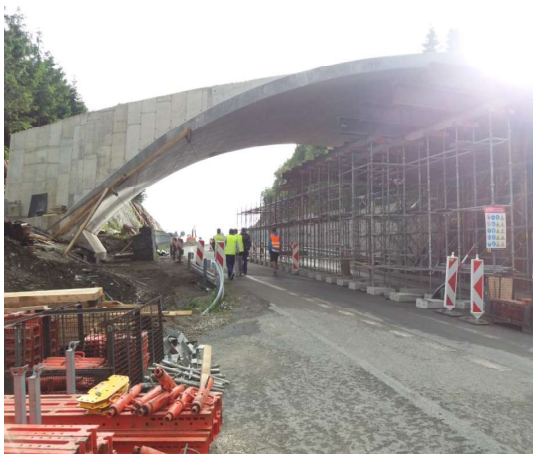
Obr. 41: Chybějící ochrana proti pádu
