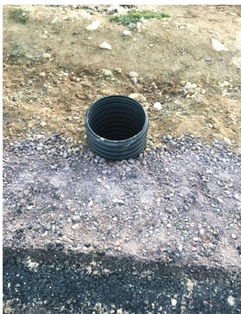
Obr. 63: Chybějící zajištění otvoru
