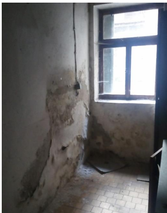
Obrázek č. 27 Značně vlhká středová stěna haly „C“
