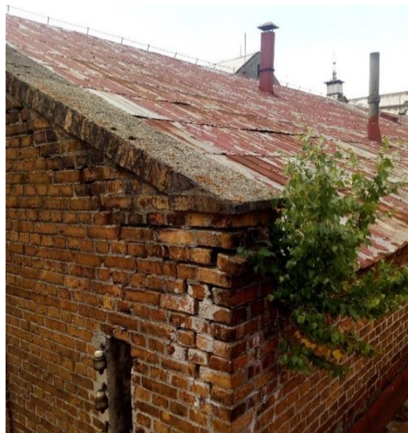
Obrázek č. 8 Destrukce zdiva na okraji štítové stěny [vlastní zdroj]
