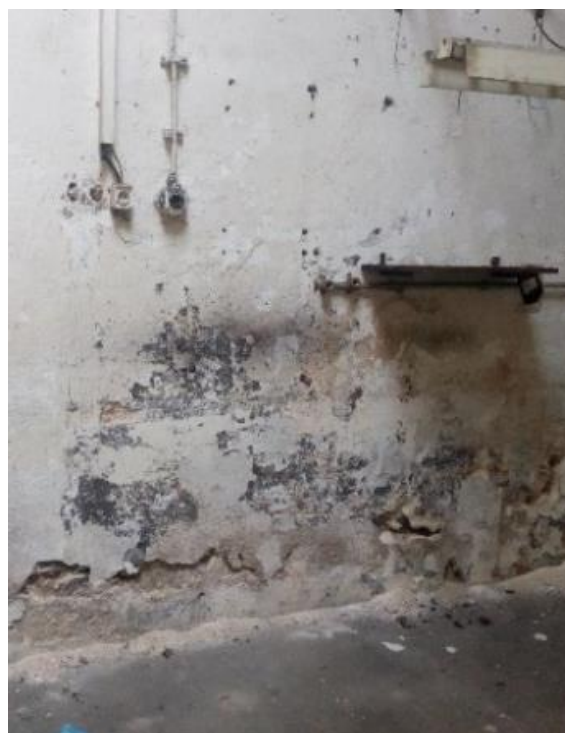
Obrázek č. 28 Destrukce omítek v bývalém skladu
