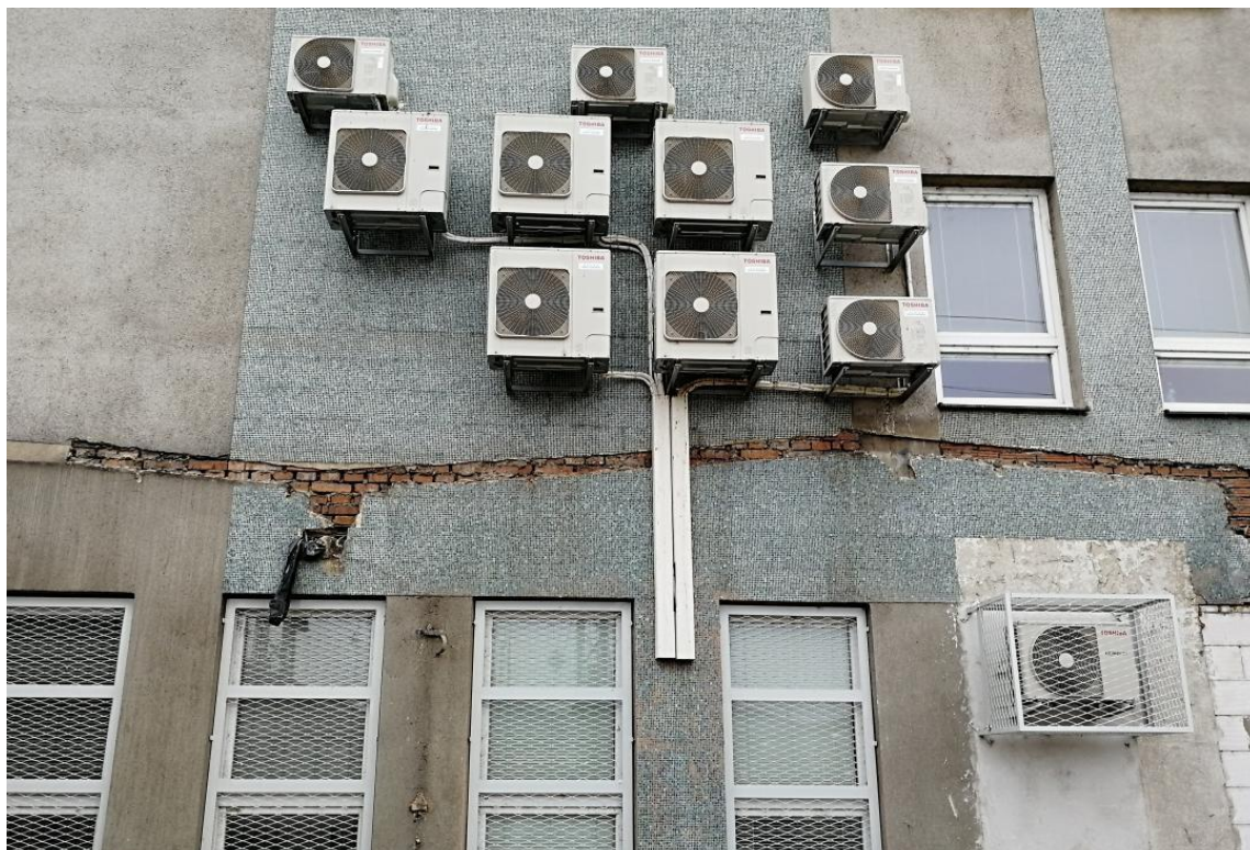
Obr. 1: Přehřívání vyřešeno? Budova vlakového nádraží. Beroun. Zdroj: autor
