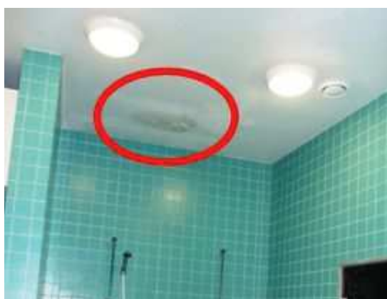
[obr.6 – příklad nevyhovující distribuce vzduchu ve sprchách]
