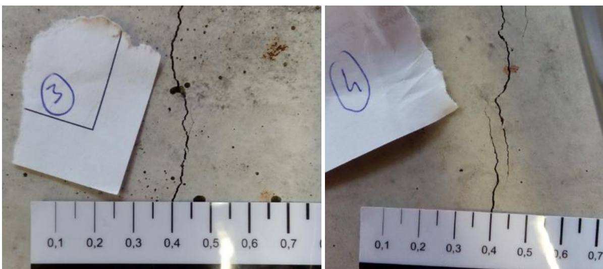
Obr. 31, 32: Obrázek vlevo a vpravo, měření trhliny po odtížení na trámci 3 a 4
