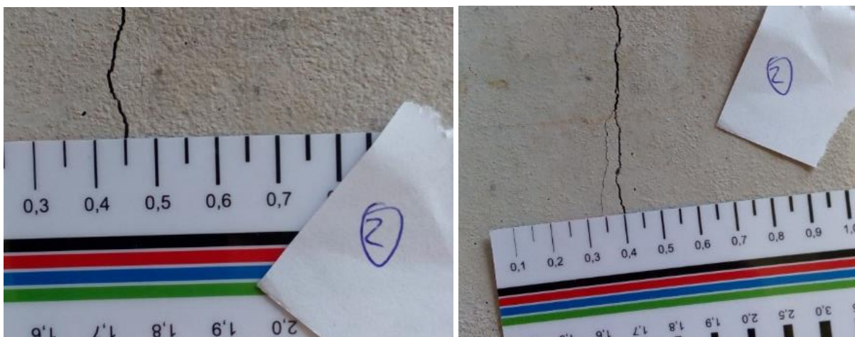
Obr. 29, 30: Obrázek vlevo a vpravo, měření trhliny po odtížení na trámci 2
