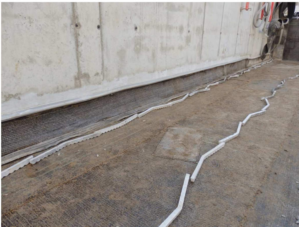
Obr. 22: Foto č.13 - Vodorovná dilatace s bentonitovou ucpávkou a středovým pásem (autor DP)
