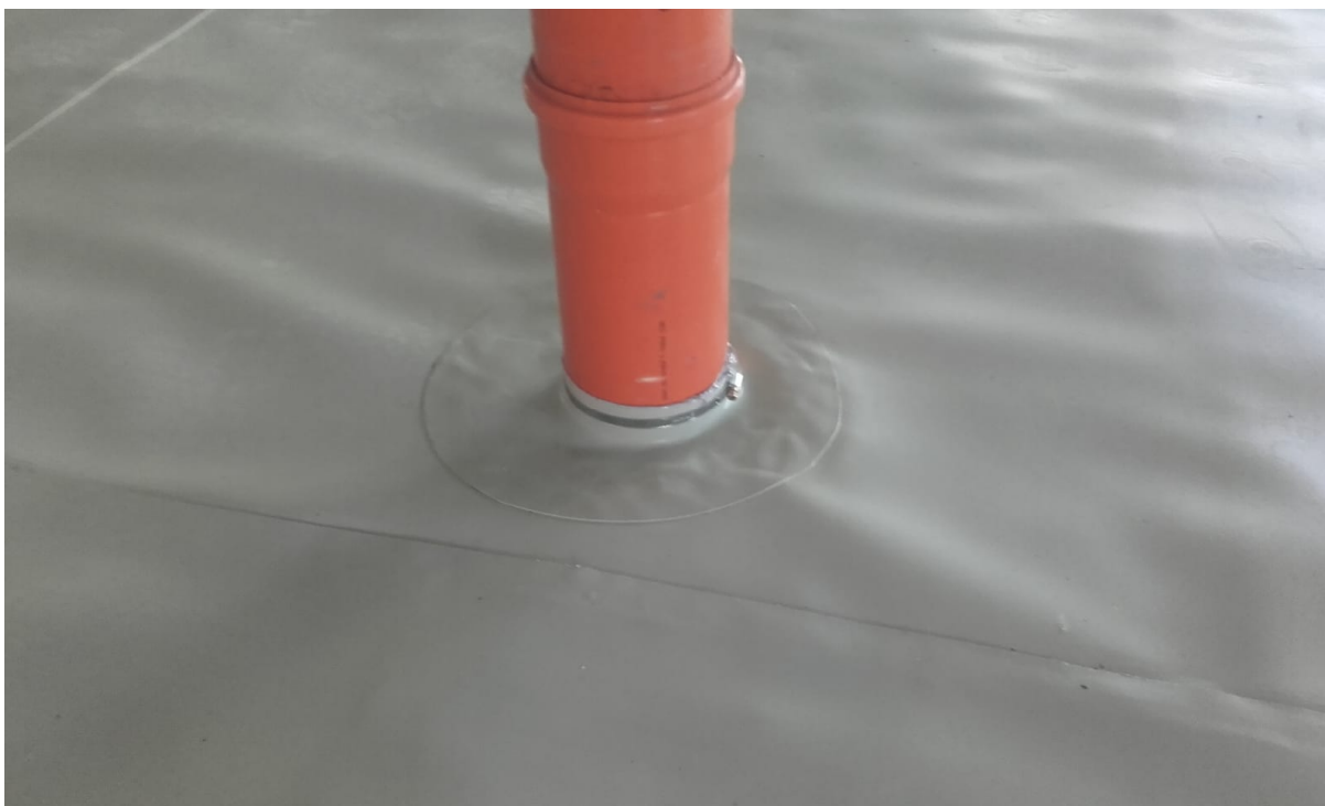
Obr. 46: Foto č.30 - prostup izolačním systémem na vodorovné ploše (autor DP)
