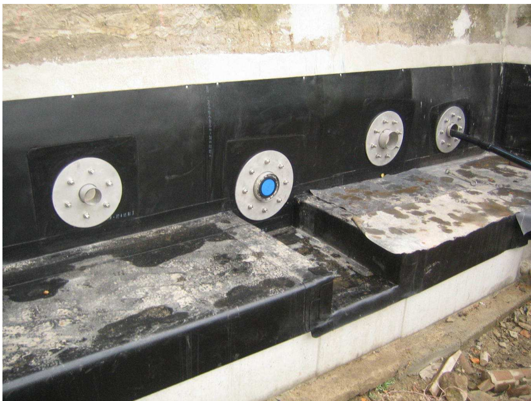
Obr. 26: Foto č.17 - Prostup na svislé ploše pevná volná příruba (autor DP)
