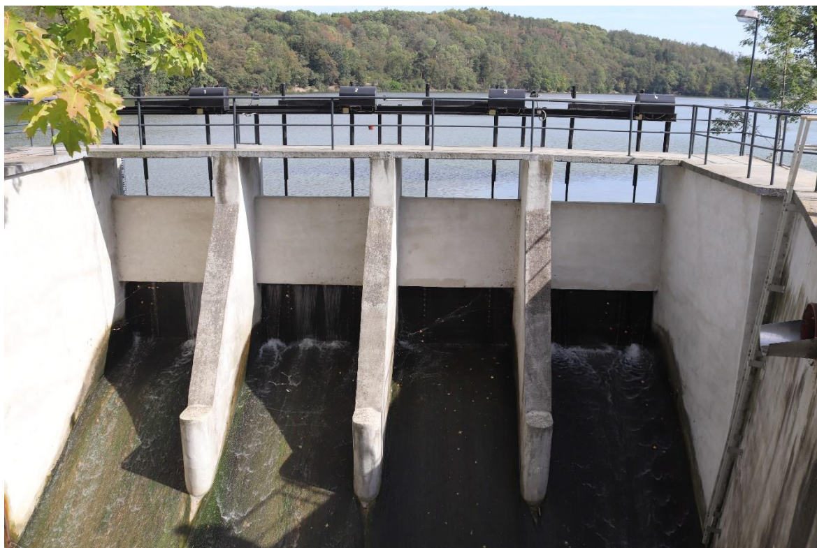
Obr. 2.4 Bezpečnostní přeliv z pohledu proti vodě
