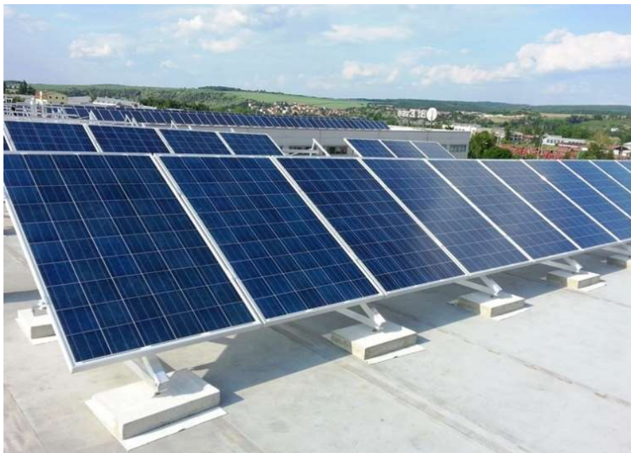
obr. 34 - fotovoltaické panely na ploché střeše střechy [www.sunwave.cz]
