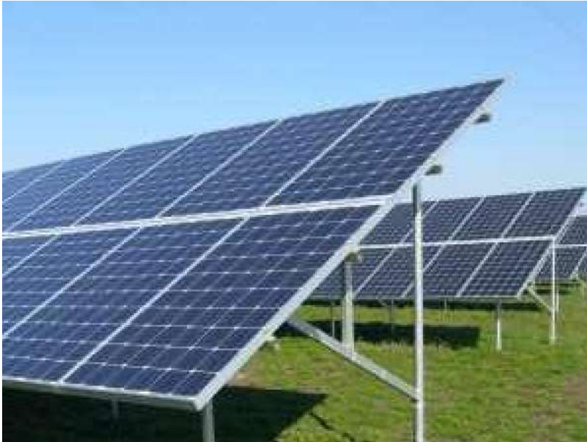
obr. 18 - Solární elektrárna Pacov [ http://www.3energy.cz/ ]
