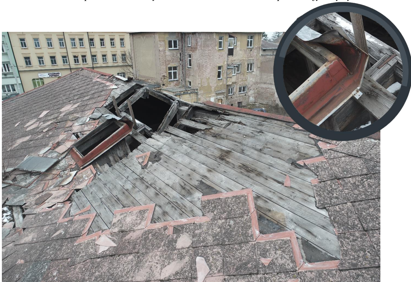
Obrázek 14: Snímek poškozené střechy, na kterou nelze z důvodu bezpečnosti fyzicky vylézt
