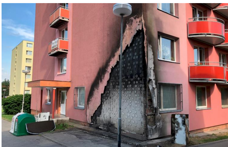
obr. 13 Fasáda bytového domu v Kroměříži po vnějším požáru, desky tepelného izolantu lepeny pouze na "bucht", požár se rozšířil spárami mezi tepelnou izolací a stěnou [17]
