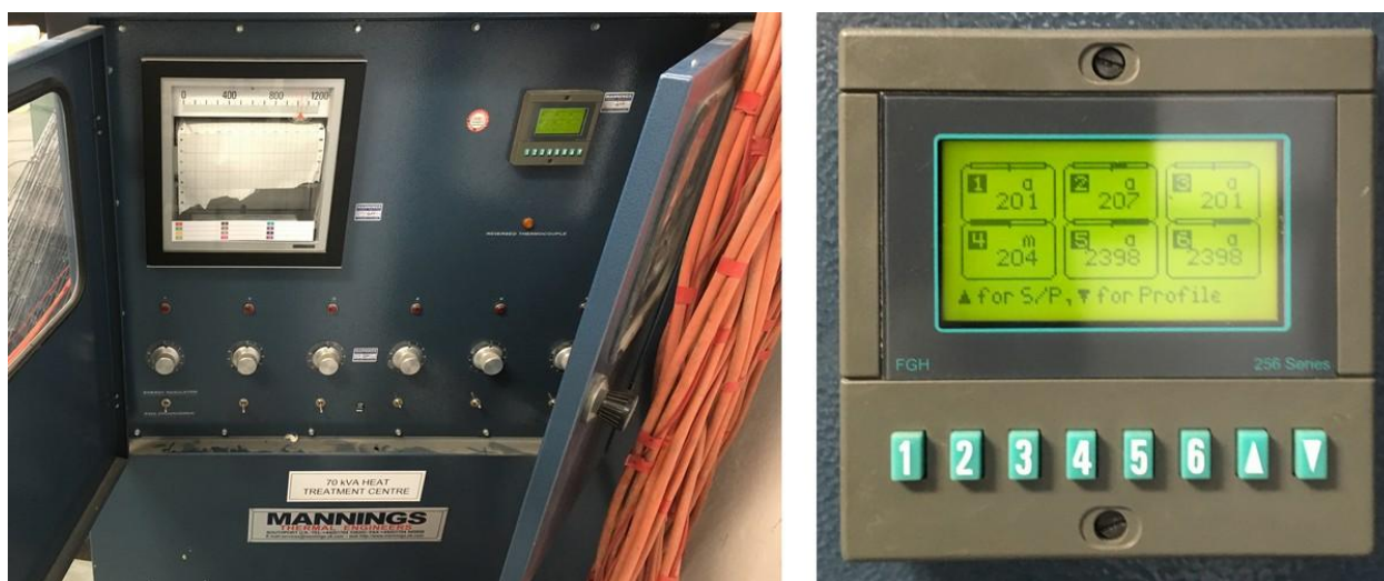
Obr. 30 – Ohřívací zařízení Mannings HTC a detail displeje ukazujícího teploty zapojených termočlánků.
