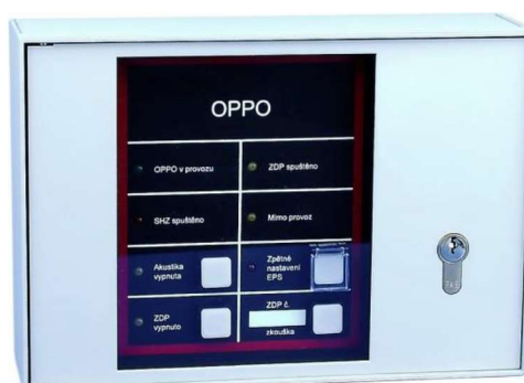
Obr. 8 Obslužné pole požární ochrany [15]
