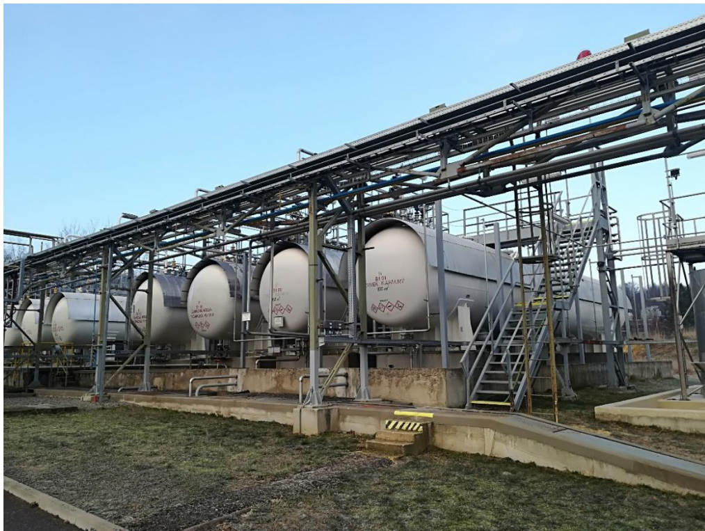
Obr. 5 - Skladovací zásobníky čpavku v areálu stáčírny chemikálií (vlastní zdroj)
