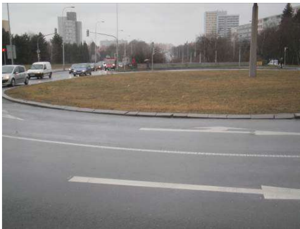
Obrázek č.18 - Pohled na poškozené obrubníky (zdroj: archiv autora)
