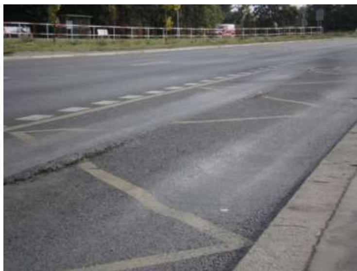
Obrázek č.26 – Pohled na poškozený povrch zastávky MHD Třeбенická (foto – archiv autora)
