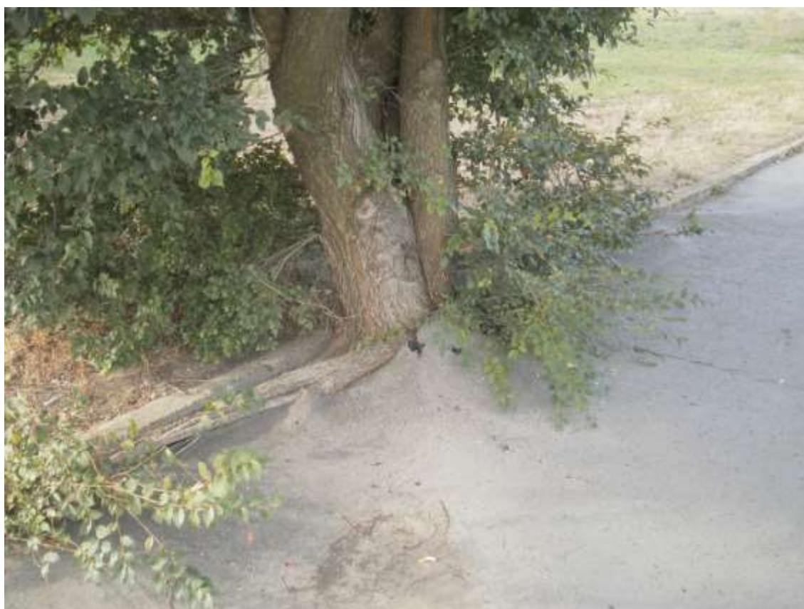
Obrázek č.28 – Pohled na kritické poškození chodníku u zastávky MHD Štěpničná (foto – archiv autora)
