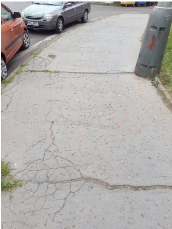
Obrázek 14 – poškození chodníkových ploch (foto autor)
