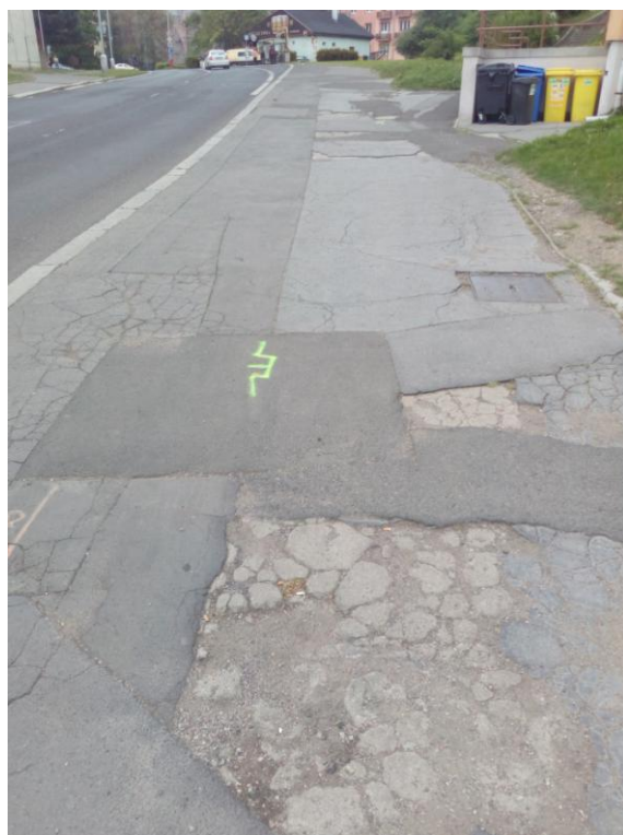
Obrázek 13 – poškození chodníkových ploch (foto autor)
