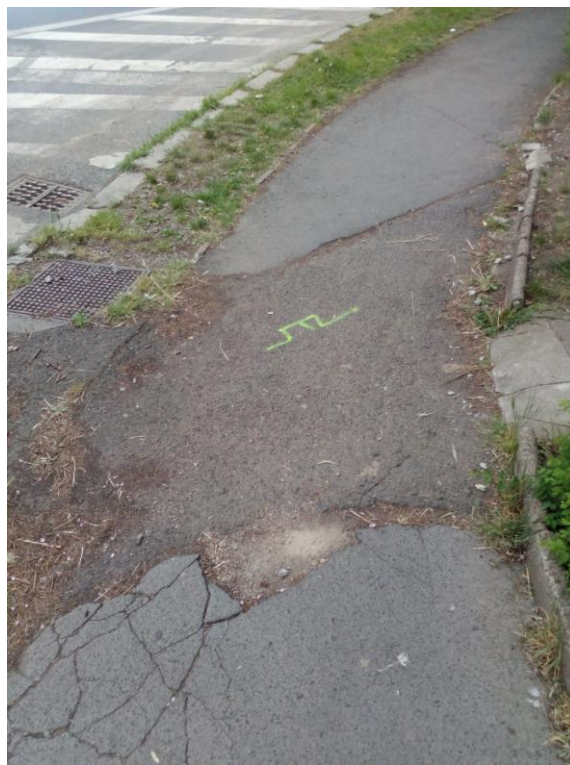
Obrázek 11 – poškození chodníku v ulici Klíšská (foto autor)
