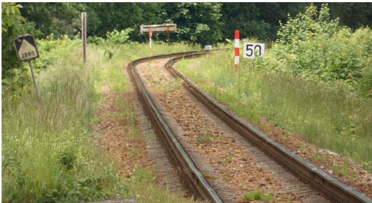
Obrázek 12: Technický stav trati u zastávky Štěpánovice
