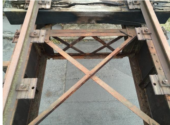
Obrázek 18 Stav železničního svršku na mostě v km 0,278 obnovovaného úseku. Mostnice jsou vyhnílé, některé zcela chybějí.
