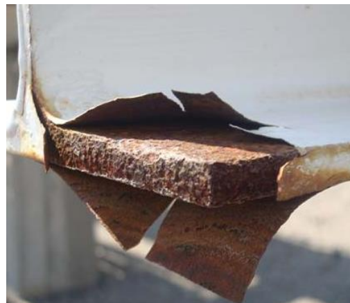
Obrázek 3: Vada nátěrů: odlupování [6]
