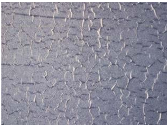
Obrázek 2: Vada nátěru: svrašťení [5]
