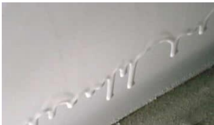
Obrázek 1: Vada nátěru: tvorba nerovnoměrného povlaku stékáním [4]
