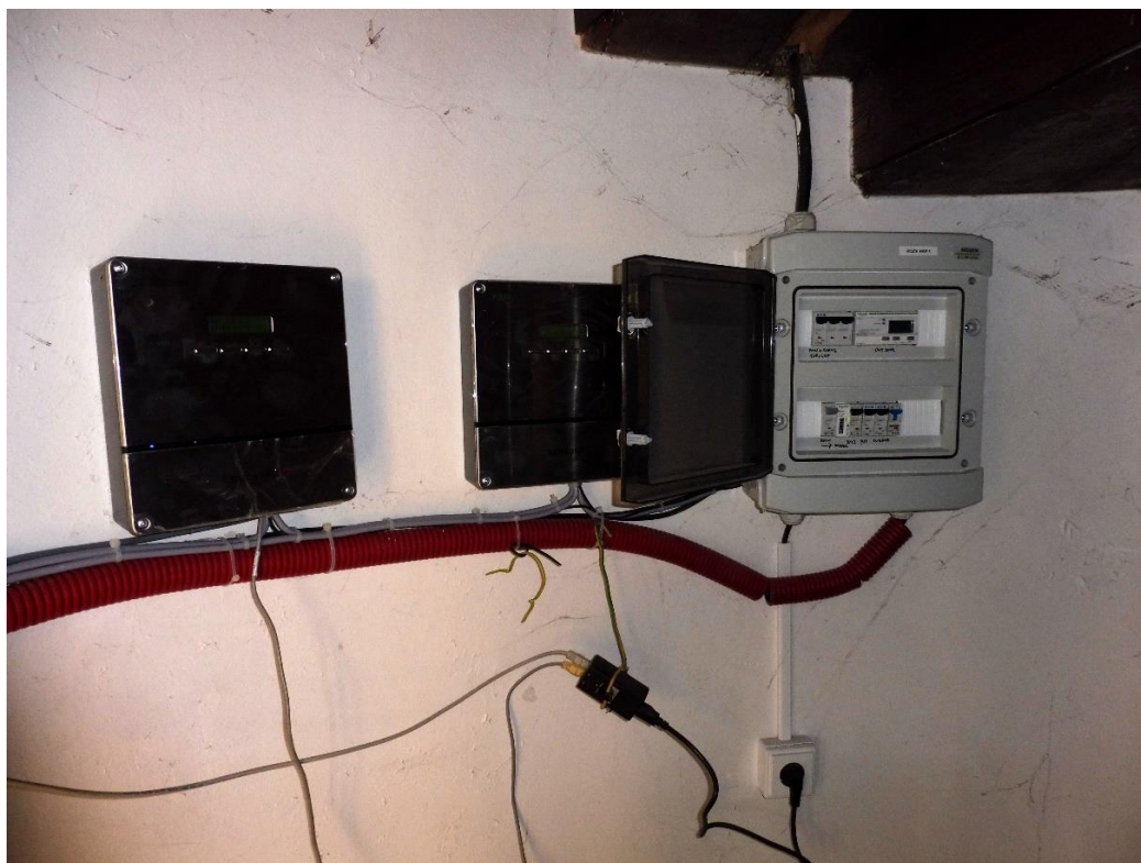
Obr. 19 – Technická místnost – (zleva) ovladač integrovaného řízení DMS 2, modul rozhraní měřiče spotřeby PIM, rozvodová skříň s elektroměry pro systém 2. a 3. NP.
