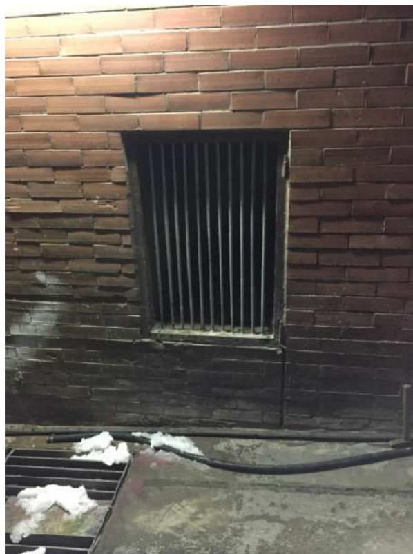
Obr. 5.7 Odvod vzduchu z haly u vstupu na ledovou plochu
