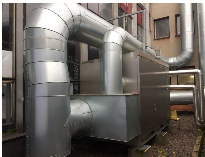
Obr. 5.9 Odvlhčovací jednotka umístěná v jihozápadní části objektu
