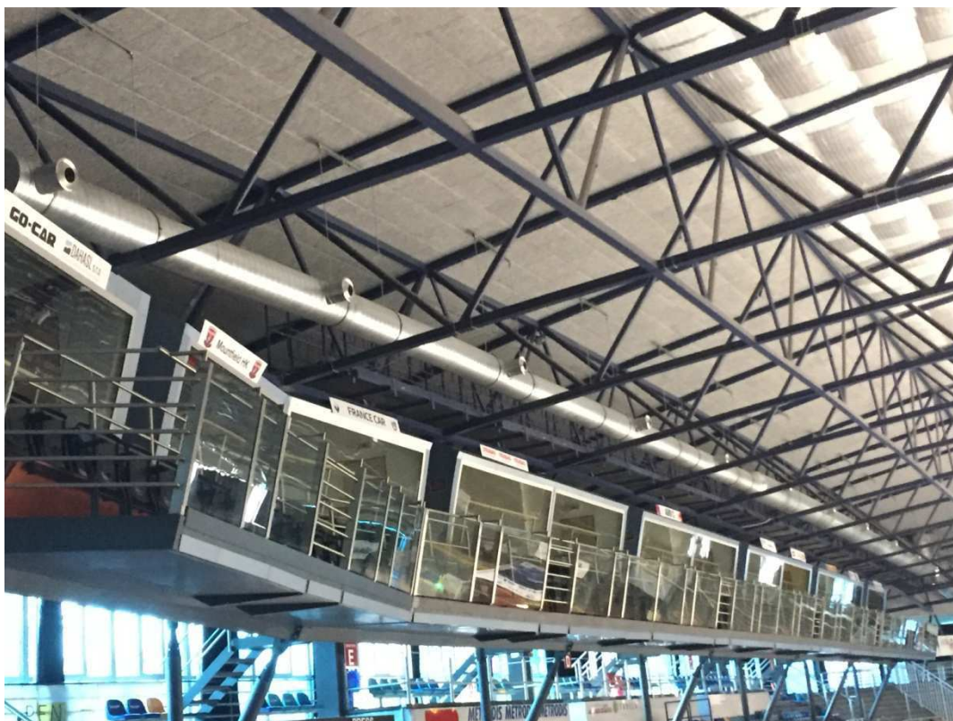
Obr. 5.10 Potrubí odvlhčeného přiváděného vzduchu umístěné nad sky-boxy
