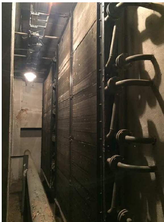
Obr. 5.3 Ohřívač vzduchu stávající vzduchotechnické jednotky
