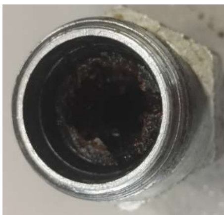
Obr. 62 – Zanešené šroubení (pohled 1)
