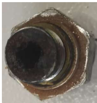
Obr. 63 - Zanešené šroubení (pohled 2)
