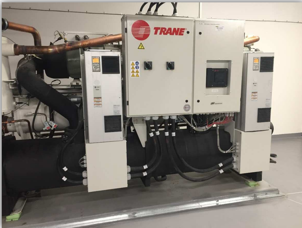
Obr. 22 Chladicí jednotka TRANE RTWD 270 HE
