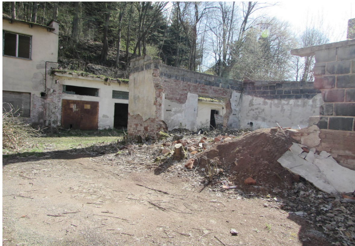
▽ vnitřní areál technické části s pohledem na rozpadlou budovu Ivan
