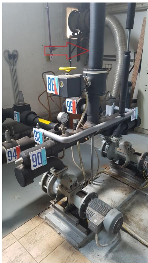
Obrázek 2 - Potrubí vedoucí z nádrže [zdroj vlastní]
