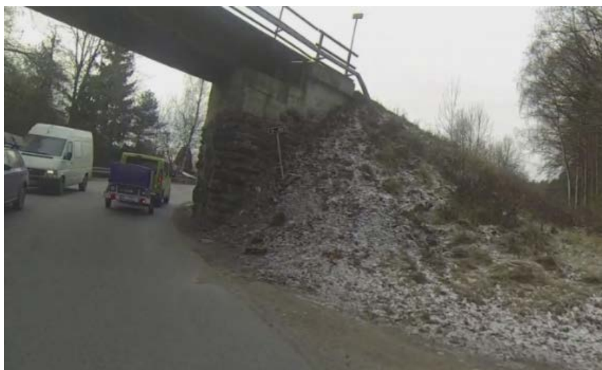
Obrázek 7 - Dopravně bezpečnostní deficit na silnici I/19 [15]
