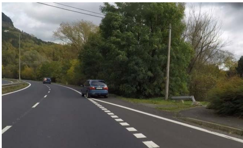
Obrázek 11 - Dopravně bezpečnostní deficit na silnici I/13 [15]
