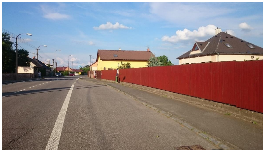
Obrázek 48 - zastávka Malín ve směru Nové Dvory (z Kutné Hory), chybí vodorovné značení V 11a
