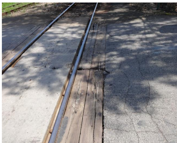
Obrázek 40 – Ukázka špatného technického stavu přejezdové vozovky v místě železničního přejezdu P3745 [69]
