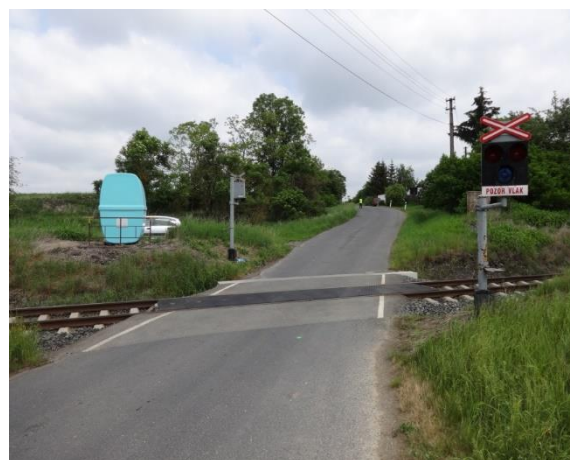
Obrázek 47 – Ukázka absence červenobílého pruhování na sloupku výstražného kříže u přejezdu P2690 [74]
