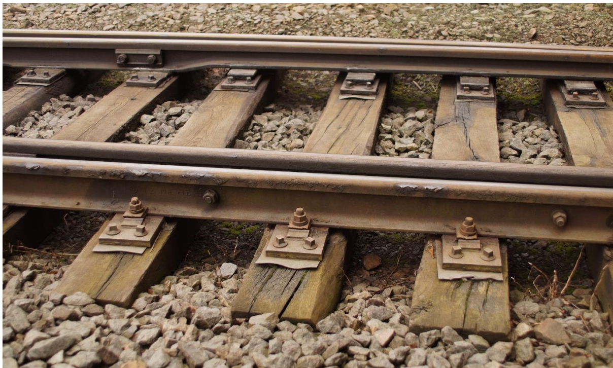
Obrázek 11: Špatný stav šterkového lože na majdalenském zhlaví
